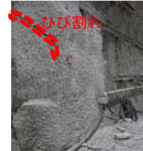
吹付けコンクリートのひび割れ
