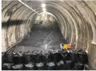
トンネル坑内土砂流入状況
