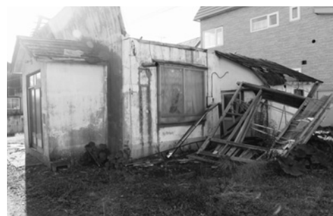
倒壊の危険がある建物
