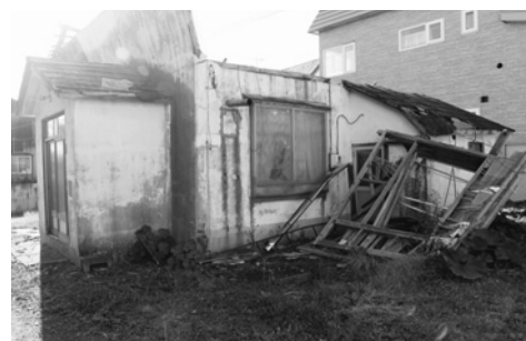
倒壊の危険がある建物
